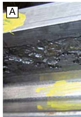
Bild A: Scharfe Kanten und Ausbrüche vor der Umstellung
